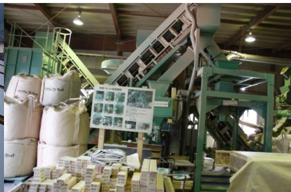
<木質ペレット製造設備>
